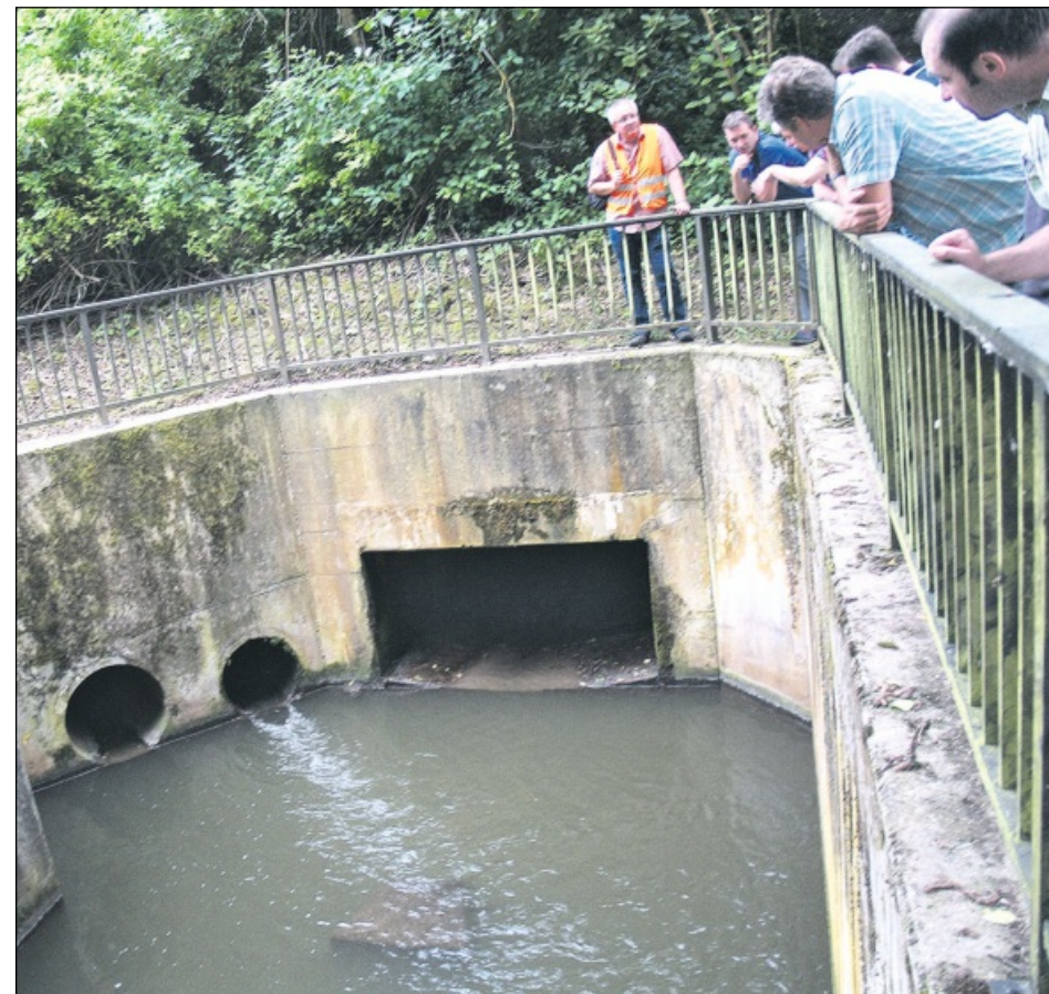
DIE MITGLIEDER des Technischen Ausschusses in Knittlingen sahen sich auch die Situation an einem Überlaufbecken an der B 35 an. Foto: efi
